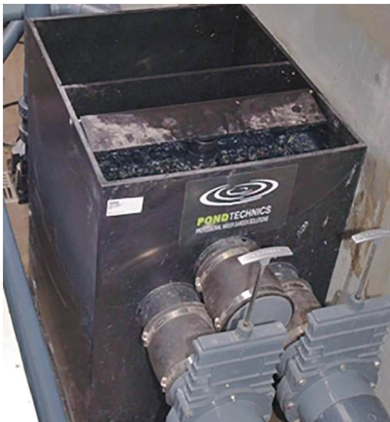
Pond Sieve in combinatie met Pond Technics Satellietiskimmer, Pond Clean UV-c unit en Messner Eco-Tec 2 pompen
